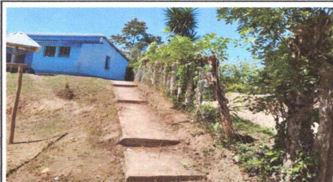
Foto 3: Mantenimiento de circulación por por deterioro
