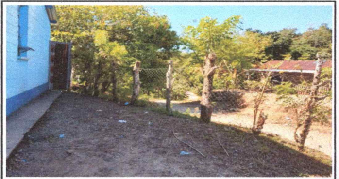
Foto 4: Mantemiento por deterioro de los postes y de malla
